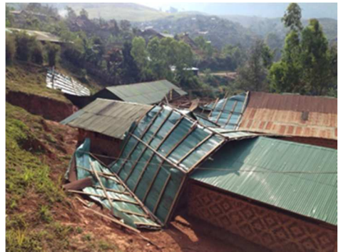
Der Tornado deckt viele Gebäude ab und hinterlässt eine grosse Verwüstung
